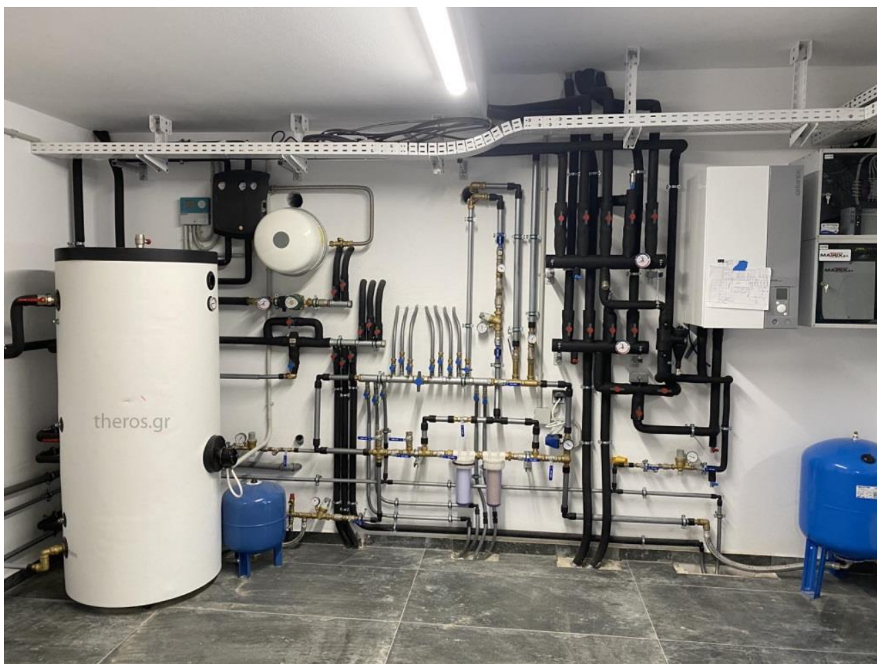
Μηχανοστάσιο στην Πάρο κατασκευής του συνεργάτη μας Γιάννη Σκιαδά με μπόιλερ ZNZ και αντλία θερμότητας
