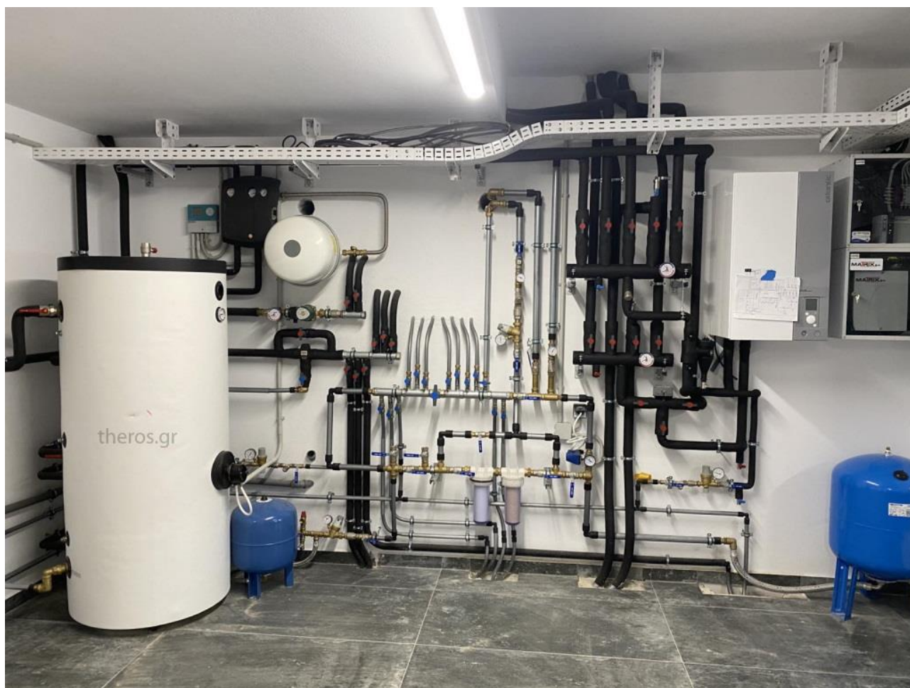
Μηχανοστάσιο στην Πάρο κατασκευής του συνεργάτη μας Γιάννη Σκιαδά με μπόιλερ ZNZ και αντλία θερμότητας
